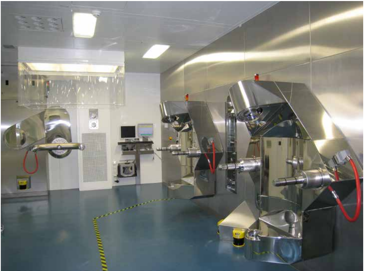
Blick auf zwei zentrale Anlagen zur Behandlung (Reinigung und Sterilisation) von Gummimaterialien für Vials und Fertigspritzen sowie eine Beladestation.
