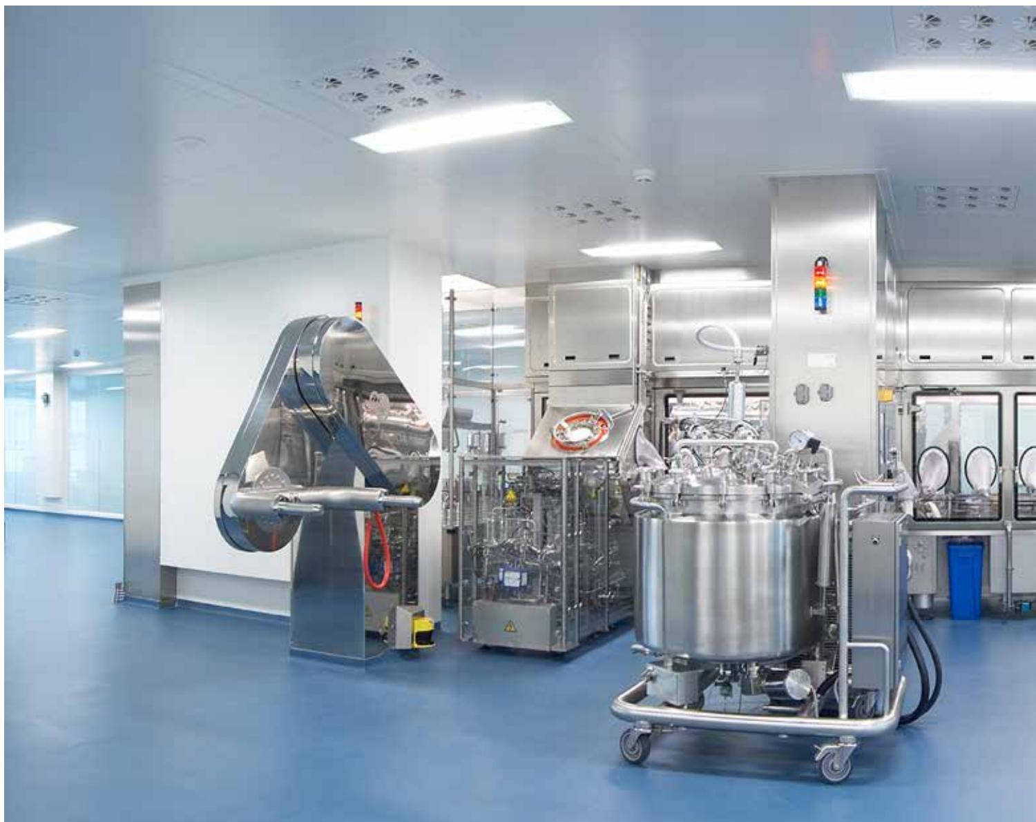
Panoramaaufnahme der Flüssigvial-Linie mit (von rechts nach links) Waschmaschine, Heisslufttunnel, Isolator zur Befüllung, Mediensäule mit Kühlanchluss für Lösungs
