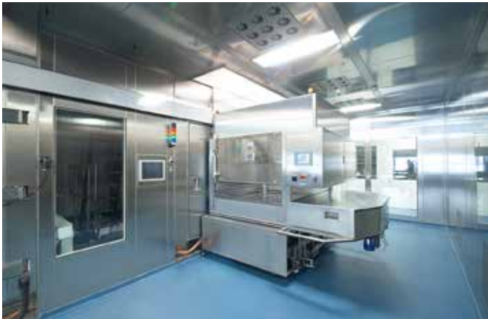
Reinraum des Gefrier-trocknungs-moduls. Blick auf den lasergesteuerten Transferwagen. Mannloser Transport von abgefüllten Vials zu zwei Gefrier-trocknern mit je 30 m 2 Stellfläche.
