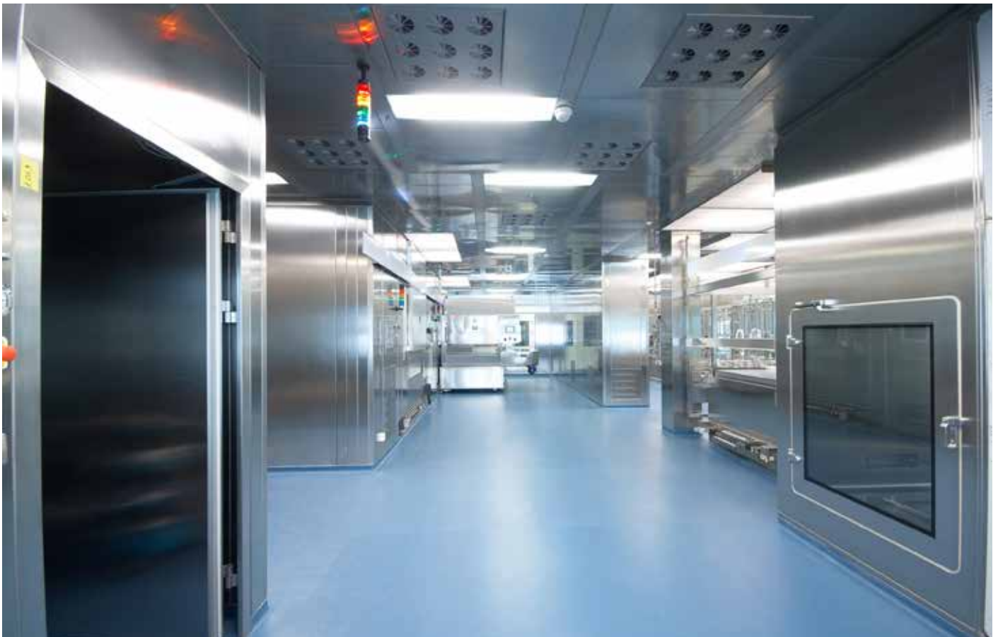
Blick in den Reinraum, Klasse B, des Gefriertrocknungsmoduls, Transport von abgefüllten Vials zu den Gefriertrocknern mittels lasergesteuertem mannlosen Transportwagen. Raum in Edelstahl ausführung mit gasförmigem H 2 O 2 dekontaminierbar.
