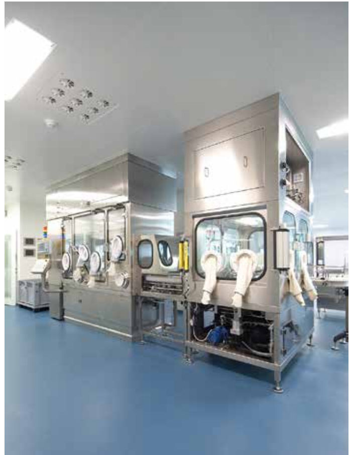
Bördelmaschine und Vial-Aussenreinigungs-Anlage im Gefrier-trocknungs-modul; jeweils in Isolatorausführung.
