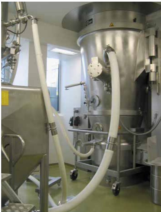
Das Bild zeigt eine Wurbschichtenanlage der Firma Glatt GmbH. Dieses Workcenter wurde komplett in Ex ausgestattet. Die Abluft wird über einen Lösungsmittelwäscher geführt.
